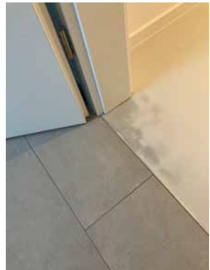
Wasserübertritt in angrenzende Räume → Schädigung der Beläge, wie zum Beispiel: Sichtspachtelmassen, Teppich oder Design-Beläge
