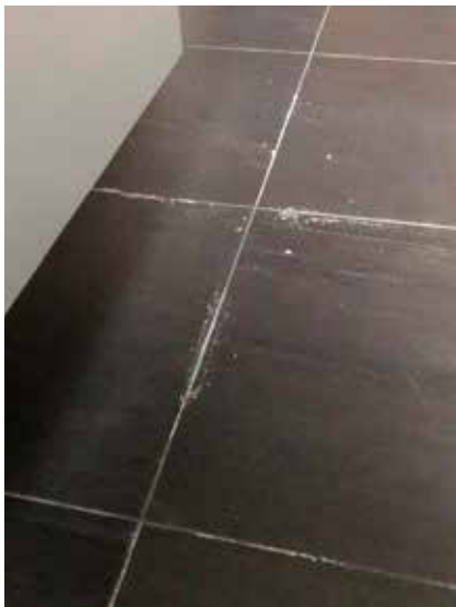
Wasseraustritt und Kristallisation von Salzen im angrenzenden Bodenbelag
