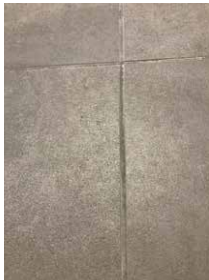
Verfärbungen/Verdunklungen der Fugen im Keramikbelag
